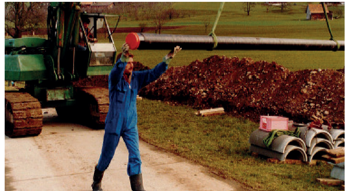
Der damalige Verkaufsleiter Bruno Solenthaler während einer Verlege-Instruktion für FZM-Rohre im Jahr 1992.
