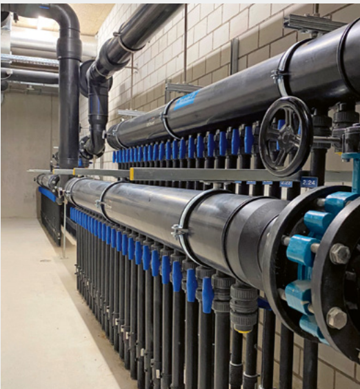
Fig. 7 Einer von sechs Erdsondenverteiltern, die den Erdspeicher bilden.
