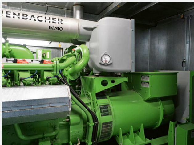
Fig. 4 Blick ins Blockheizkraftwerk mit dem Gasmotor von Jenbacher.
