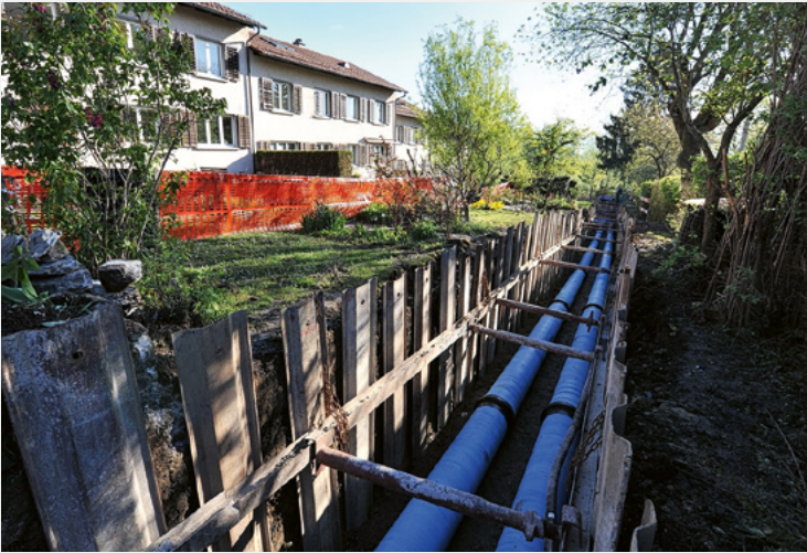
Fig. 5 Anergieleitungen im Wohnquartier.
