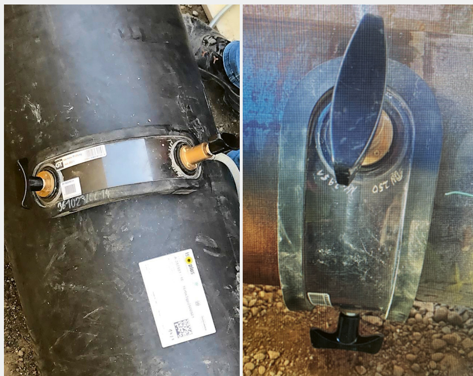
Fig. 2 Dichtheitsprüfung mit Vakuumbrikle. Die Brikle wird auf die Schweissnaht aufgesetzt und ein Vakuum erzeugt. Wirft die Naht Blasen, ist sie undicht.
