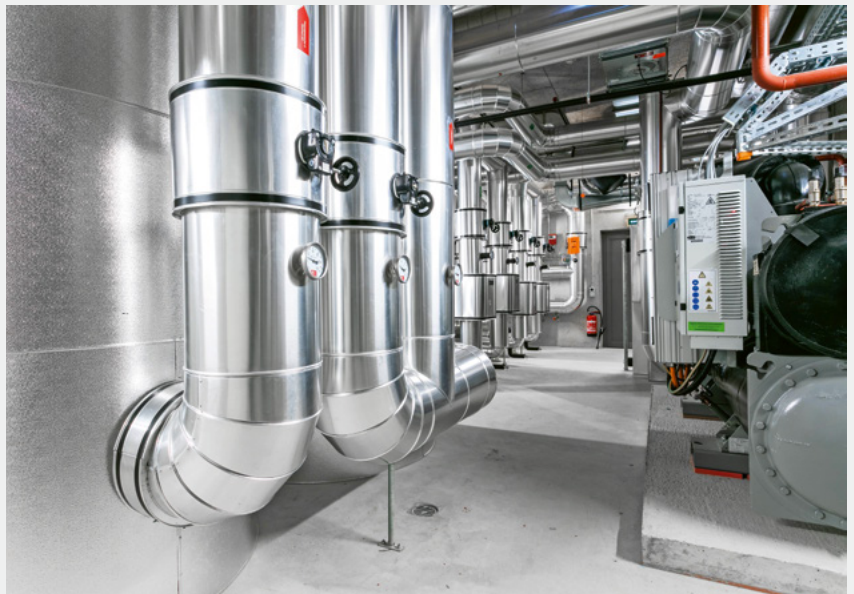
Fig. 8 Eine von sechs Energiezentralen mit Wärmepumpe.
