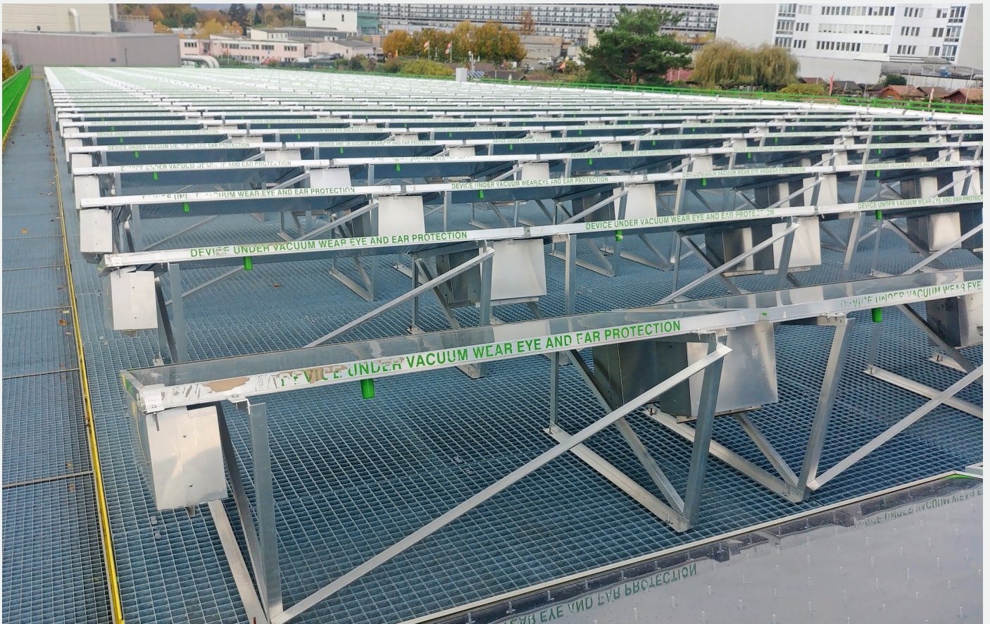
Fig. 2 Kollektorenfeld des solarthermischen Kraftwerks SolarCAD II der SIG in Genf.
